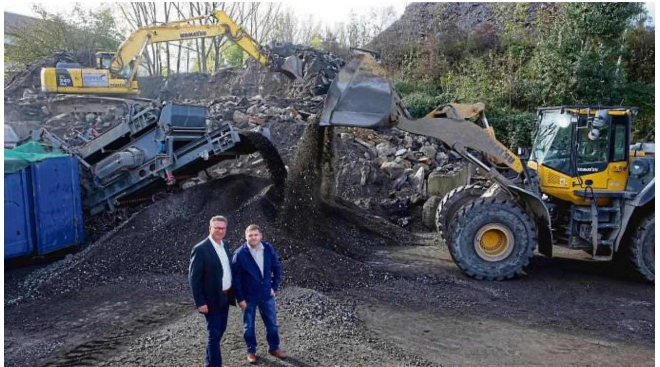
In 25 Jahren acht Millionen Tonnen Bauschutt behandelt: Geschäftsführer Dirk Röth (links) und Vertriebsleiter Jens Andrecht auf dem Betriebsgelände von Baureka an der Dennhäuser Straße.
